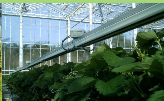
Moderne Technik, z.B. LED-Beleuchtung
